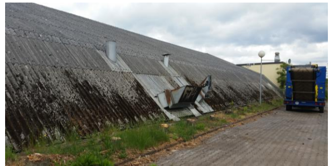
Abb. 2: Dacheindeckung aus Wellasbestzementplatten der vorderen Halle
