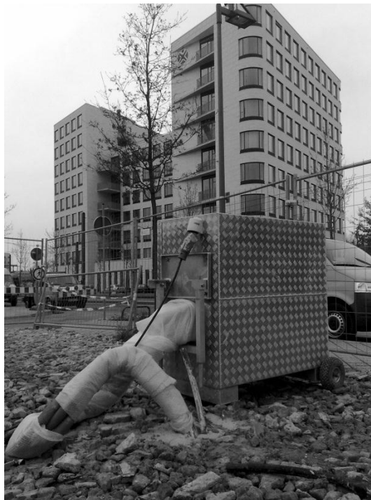
Bild 5 Response Test-Gerät zur Untersuchung beim Wohngebäude mit dem Verwaltungsgebäude im Hintergrund
